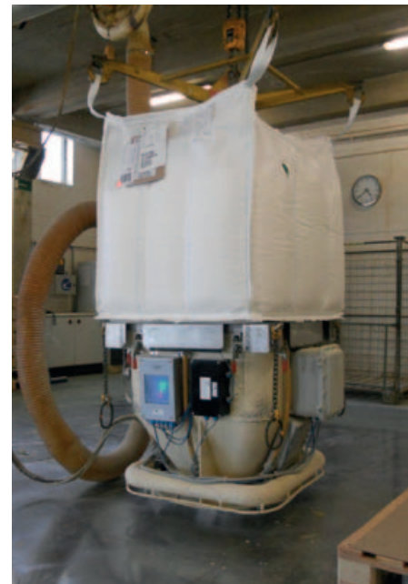
Afb. 2 Het Earth-Rite Multipoint II-systeem controleert de aarding van verschillende onderdelen van een afzakinstallatie voor poeders
